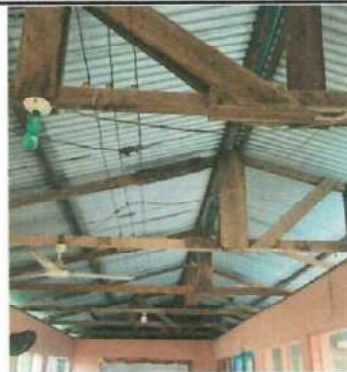
Foto 4: Esta panorámica permite observar con mayor detalle la estructura de madera que soporta el techo y que según se observa ya tiene deterioro.
