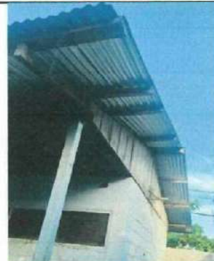
Foto 2: Se evidencia que la lámina que cubre esta parte de este edificio tiene deterioro.
