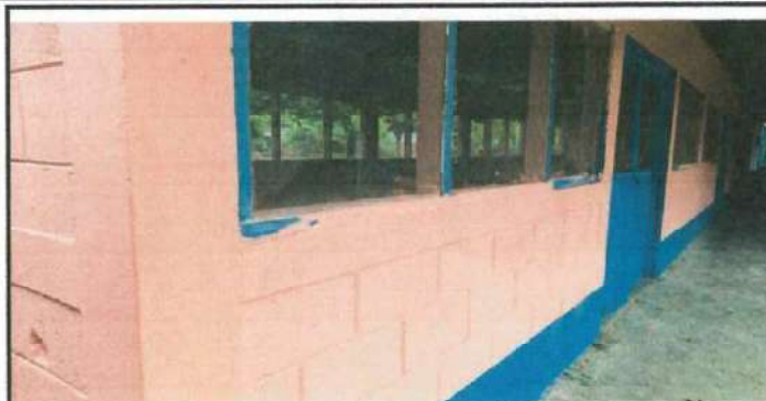
Foto 2: En esta vista también se observa que este salón no tiene balcones y por seguridad es necesario su colocación.
