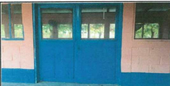
Foto 6: Esta puerta da acceso a una de las aulas, se observa el tipo de puerta y el estado en que se encuentra los materiales de que estan hechos.
