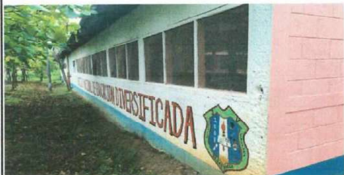
Foto 1: Este edificio no presenta en ninguna de sus ventanas balcones, siendo necesario por los materiales y enseres que están dentro del salón de clases.
