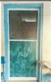
Foto 5: Se observa el daño que tiene esta puerta que da acceso a un salón de clases.
