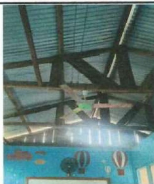
Foto 3: En esta parte del techo hay filtraciones de agua, por lo que es necesario realizar el cambio de techo.
