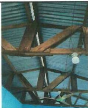
Foto 3: Esta parte es el interior de una de las aulas, todo el soporte de techo es de madera y algunas partes están muy deterioradas.
