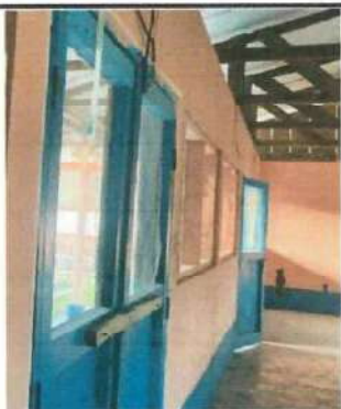
Foto 3: Se evidencia el deterioro que ha sufrido la puerta, visto desde dentro y como se ha mantenido..
