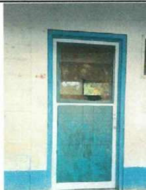
Foto 2: La puerta es de madera y presenta daños en su estructura..
