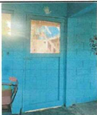
Foto 1: Se observa una de las puertas de las aulas que tiene este edificio, vista desde adentro, la parte de madera se ha mantenido por la pintura, sin embargo la parte de malla se ha deteriorado.
