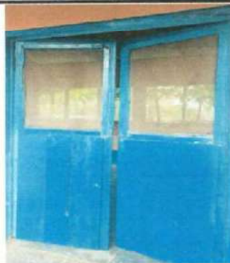
Foto 4: Esta puerta es doble, se evidencia el material con que esta hecha y el deterioro que tiene. Con malla se le ha dado forma.
