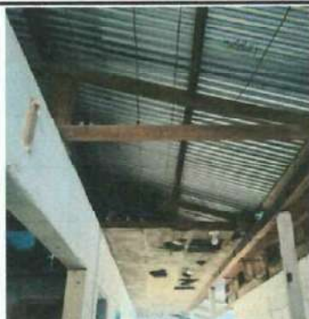
Foto 5: Se observa otra panorámica del soporte de techo.
