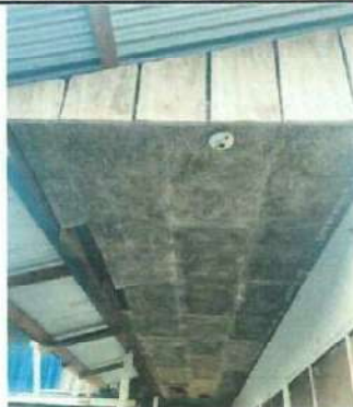
Foto 2: Todo la estructura del soporte del techo es de madera, se observa que tiene cielo falso, pero este representa peligro debido a que no esta bien fijado.
