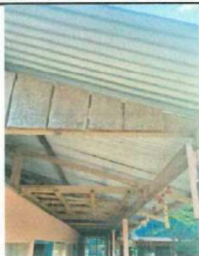
Foto 1: A la vista se tiene el material que tiene el techo de este edificio, se tiene previsto cambiar la estructura metálica, por lo que el techo no se podrá seguir utilizando el mismo.
