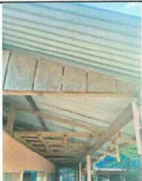
Foto 1: Se evidencia que el material que tiene el soporte del techo es de madera y en la actualidad sufre deterioro por el tiempo y los por insectos que consumen madera.
