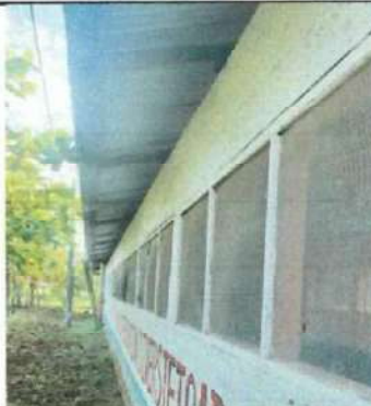
Foto 4: La lámina que cubre esta parte del edificio es de bajo calibre.
